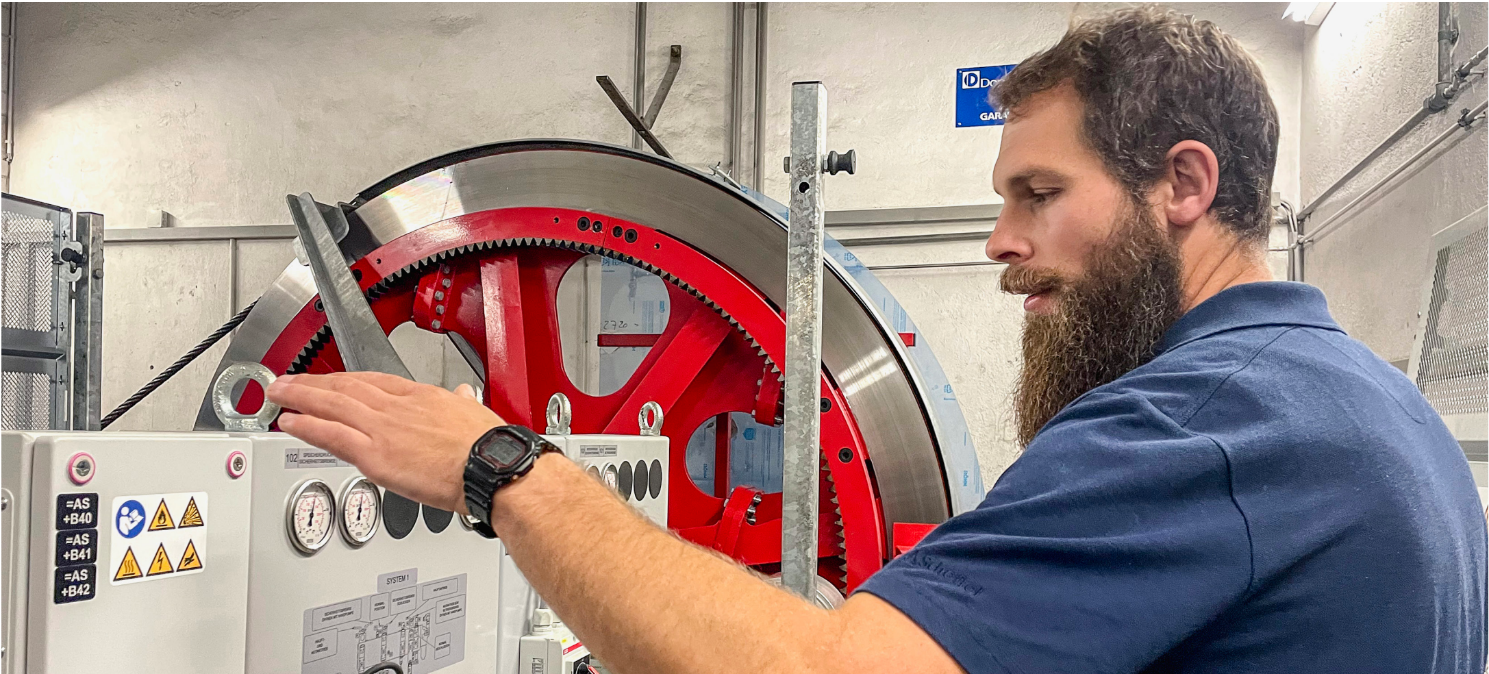
Das Antriebsrad (rot) ist mit einer Sicherheitsbremse ausgestattet. Im Notfall bremsen diese das Antriebsrad, die Wagen hängen dann sozusagen in den Seilen.
