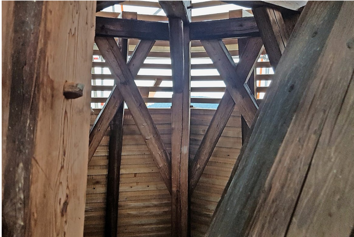
Wird im Gebälk des Kirchturms Aeschi (dieser wird zurzeit neu gedeckt) dereinst eine neue Mobilfunkantenne installiert oder nicht? Foto: PD
