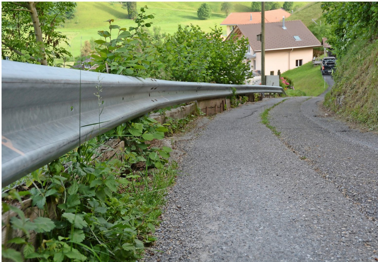
Die steile Bruchgutstrasse kann auf einer Länge von 60 Metern für 249 000 Franken saniert werden. Foto: Stefan Kammermann
